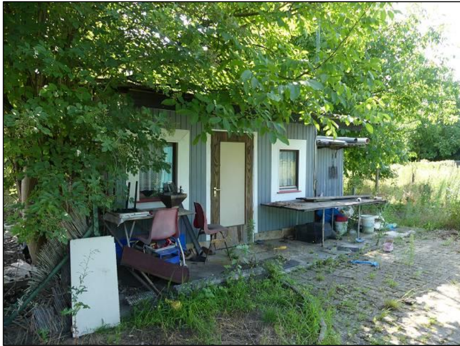
Abb. 11: Gartenhütte im südlichen Teil des Geltungsbereichs, potenzielle Quartierstandorte für Fledermäuse und potenzielle Niststandorte für Vögel (21.07.2020)
